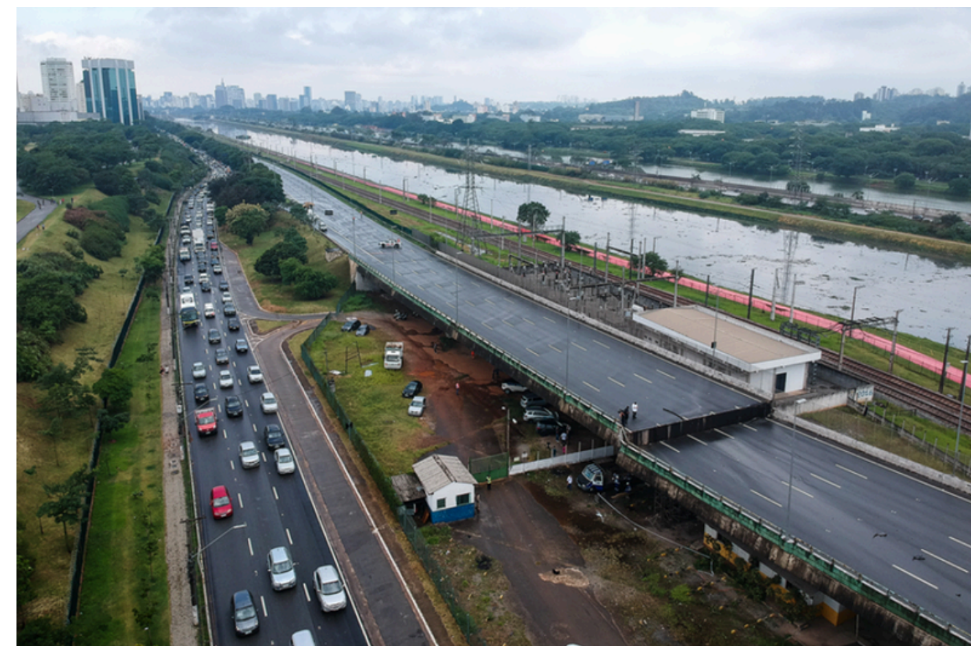
Viaduto Marginal Pinheiros cede 2 metros, São Paulo, Nov/2018
