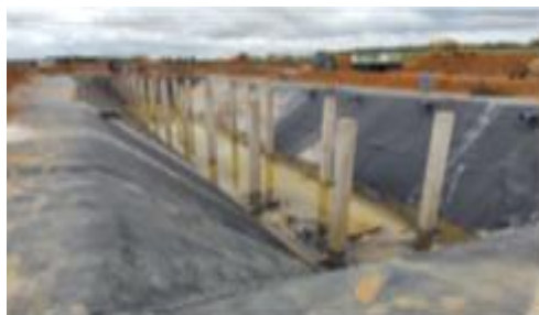
Figura 1 - Estação de Tratamento de Esgoto Sanitário - Bairro Crixá
