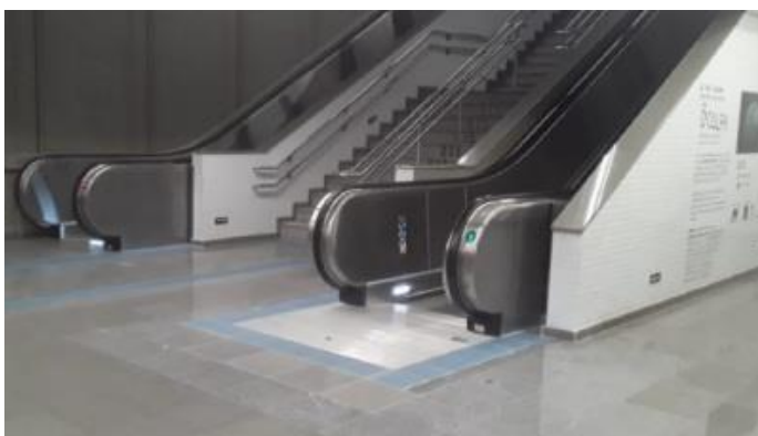
Figura 7 - Escada rolante instalada na Estação 106 Sul
