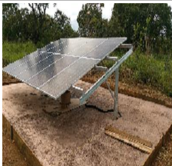
Foto 20. Módulos geradores de energia fotovoltaica
