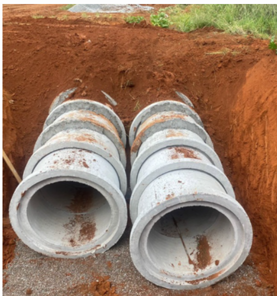
Rede de drenagem pluvial
