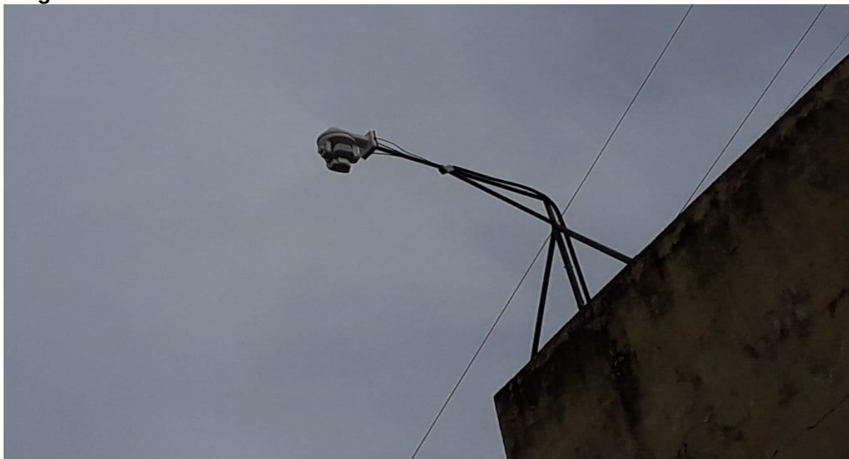
Figura 2 - Câmera Dome encontrada em local distinto do registrado no sistema de guarda de bens
