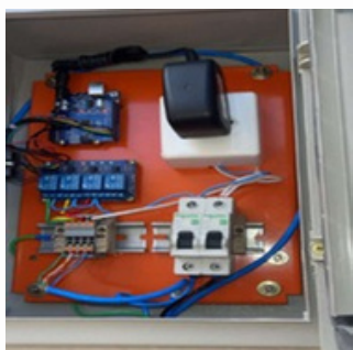
Quadro de controle
