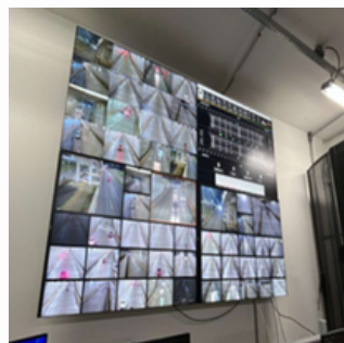
Vídeo Wall de monitoramento e operação das câmeras e do supervisão do sistema de automação
