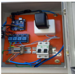
Quadro de controle
