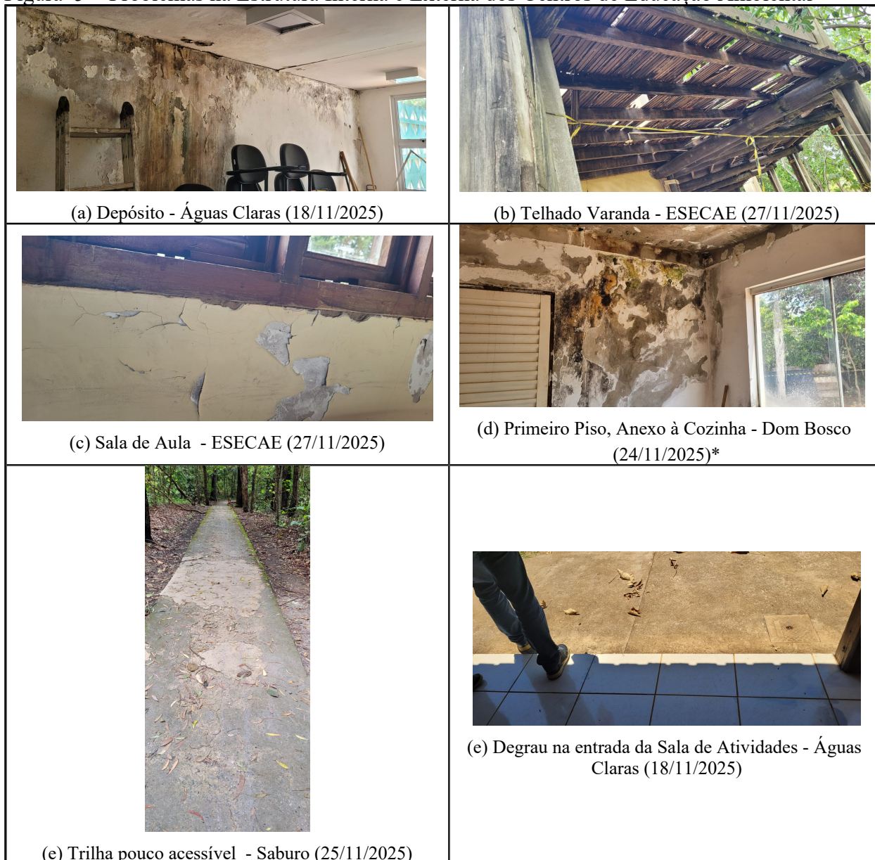
Figura 5 - Problemas na Estrutura Interna e Externa dos Centros de Educação Ambiental
