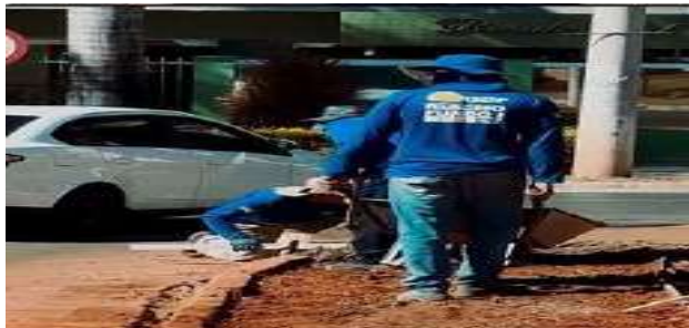
Manutenção das calçadas
