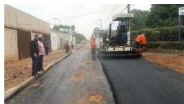
QMS 60, incluindo o recapeamento das áreas em que o asfalto se encontrava degradado.
