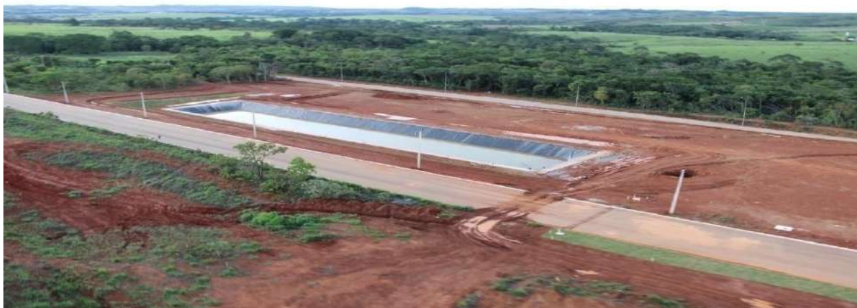
Foto 11: Tanques para recebimento de águas pluviais
